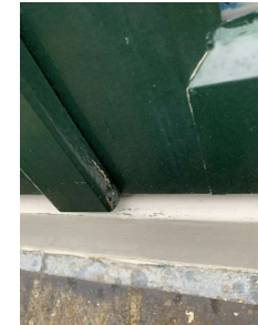
Schade door te beperkte ventilatie onderdorpel
